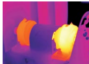
Перегрев крышки подшипника
